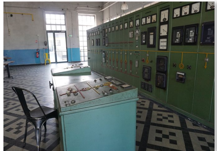
La Salle des Turbines
