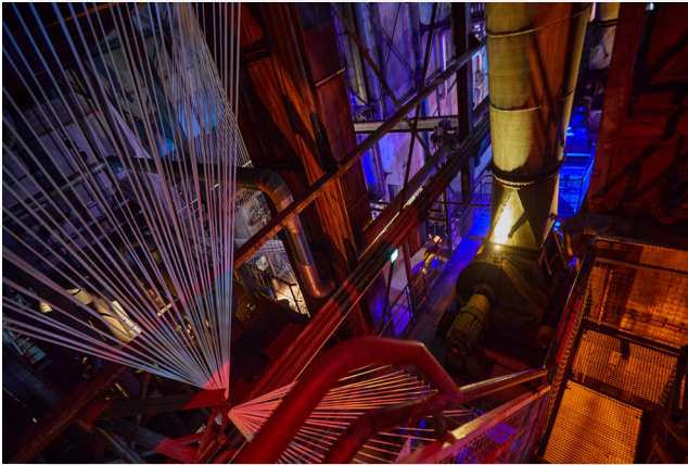
La Grande Chaufferie intrigante
